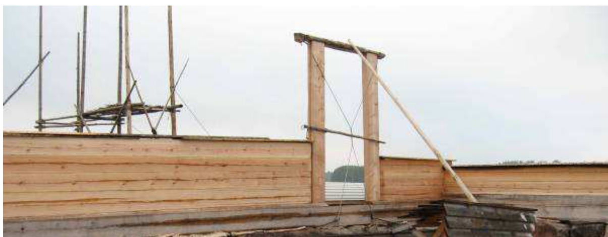
BILD 15. Sydportalen är monterad för timring på gåt. Till vänster i bakgrunden ser vi säsongens ställningsexperiment, se separat rapport på www.sodrarada.se . Foto Robert Carlsson.
